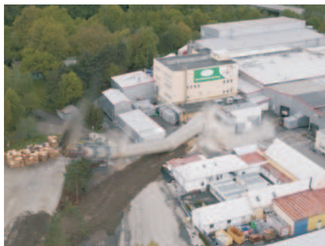
Obr. 6 Zalomení žb tvárniceového komína (Veselí nad Lužnicí 25. 5. 2021)
