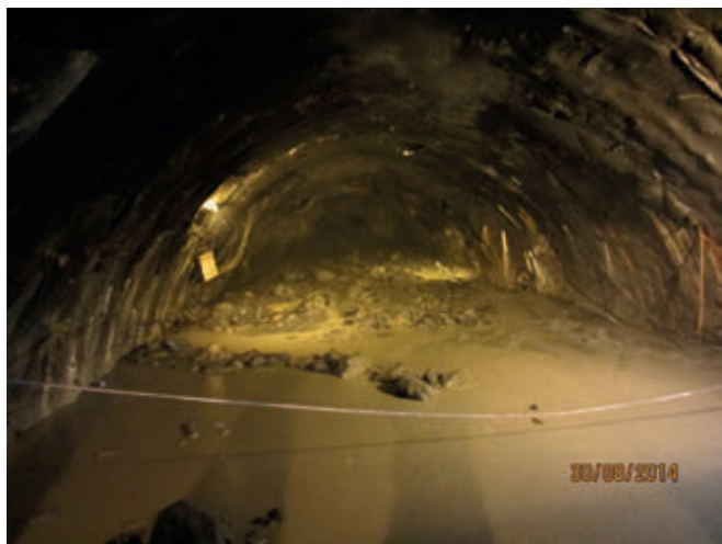
Obr. 6: Vyplavení materiálu v kalotě tunelu ve staničení 2+390 ze dne 30. 8. 2014
