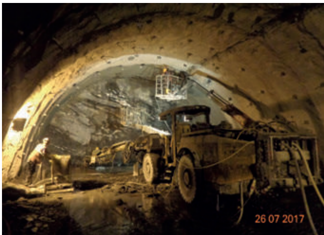
Obr. 8: Jedna řada mezer v primárním ostění za čelem kaloty, NP v červenci 2017
